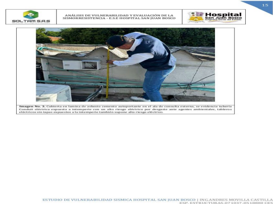
Img. 2 – Cubierta en lámina de asbesto cemento: tubería Conduit expuesta y tableros eléctricos sin protección
