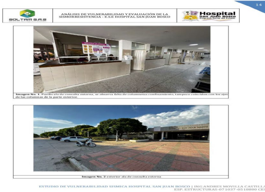
Img. 1 – Pasillo ala de consulta externa: ausencia de columnetas de confinamiento, ejes de columnas no coinciden con mamposterías
