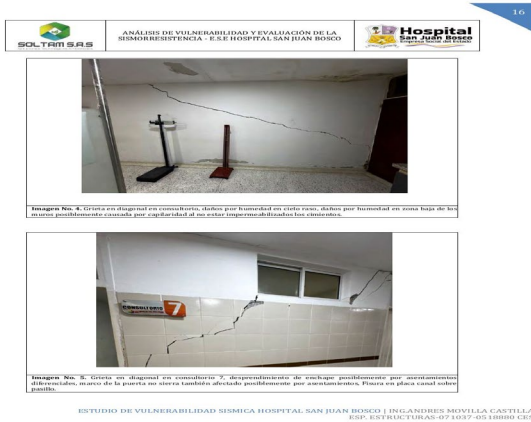
Img. 3 – Grieta diagonal en consultorio, daños por humedad en cielo raso y muros por capilaridad
